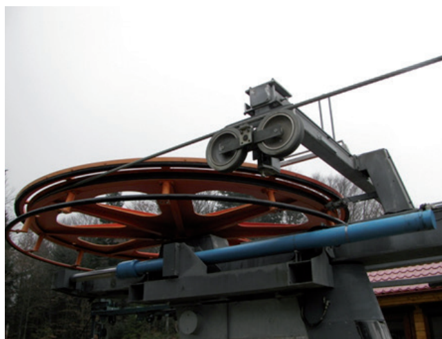
Rys. 7. Hydrauliczne urządzenie napinające kolei linowej „Słotwiny TAB” w Krynicy Zdroju
