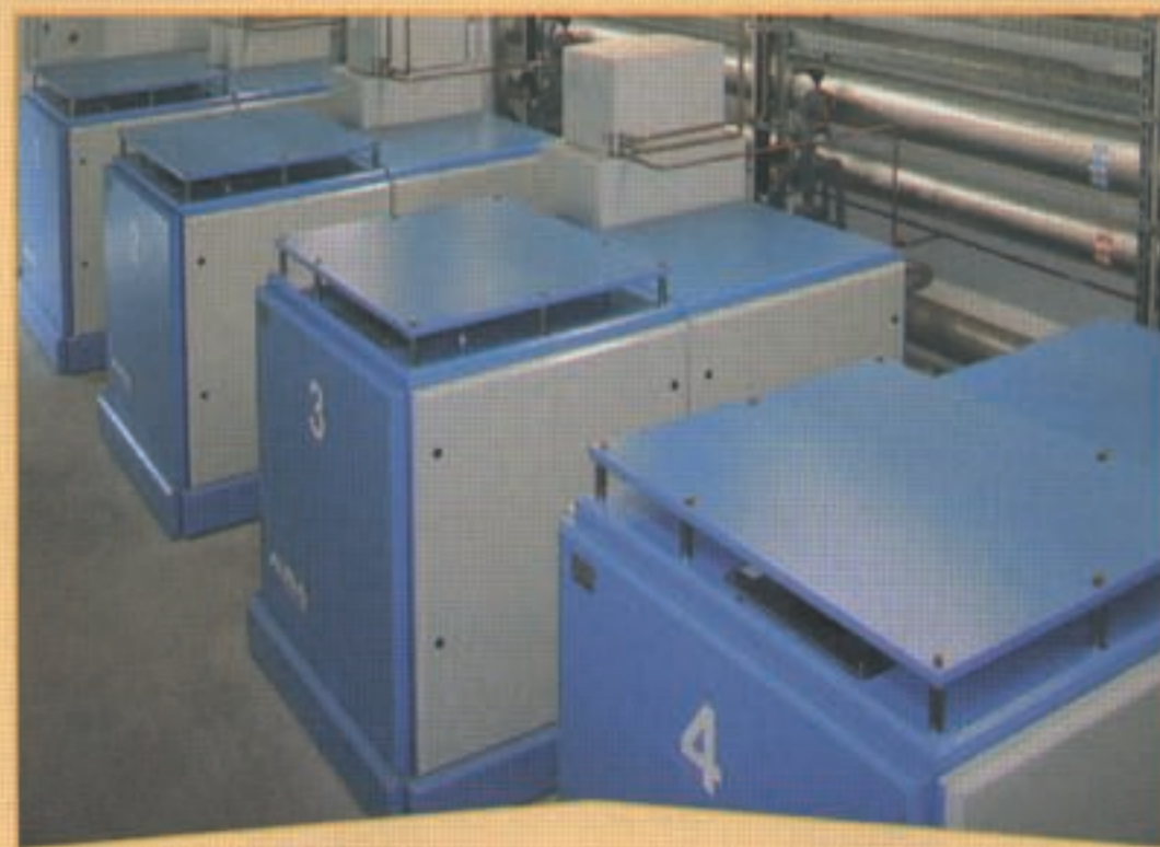
Fot. 3 Przykład nowoczesnej stacji sprężonego powietrza z energooszczędnymi sprężarkami firmy ALMiG
