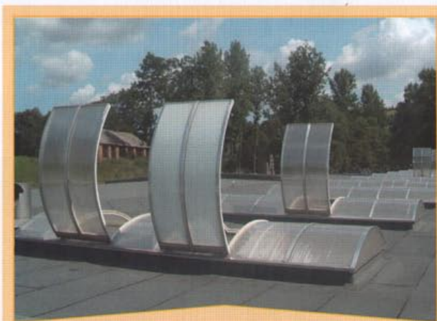
Fot. 2 Pasma świetlne umożliwiają doświetlenie światłem naturalnym niemal każdego miejsca w pomieszczeniu
