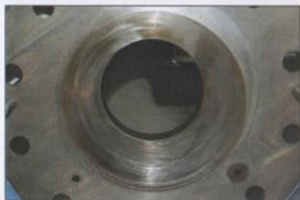
Fot. 3 Zniszczona powierzchnia robocza pokryw bocznych komory sprężania w wyniku zbyt małego ciśnienia oleju spowodowanego zastosowaniem nieoryginalnych filtrów
