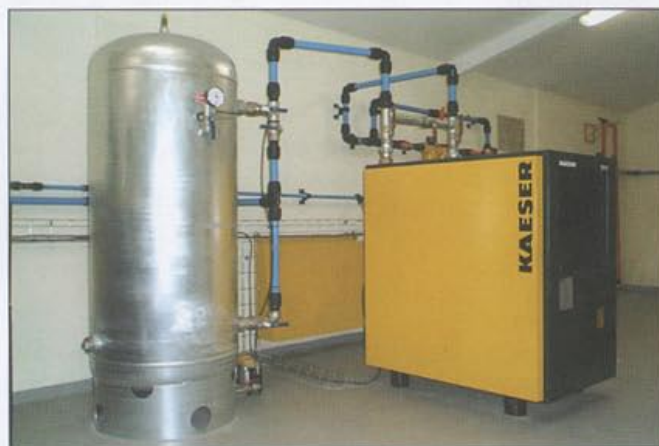
Fot. 3 Energooszczędna sprężarkownia
