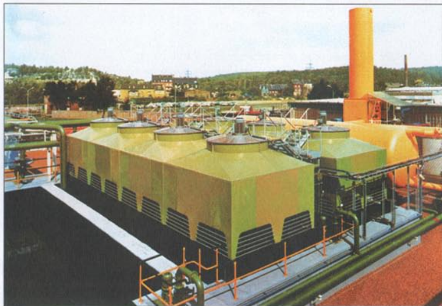
Fot. 2 Zespół chłodni wentylatorowych współpracujących z systemami wody chłodniczej zakładu przemysłowego
