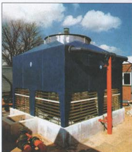
Fot. 1 Przykładowa chłodnia wentylatorowa (firmy GEA)
