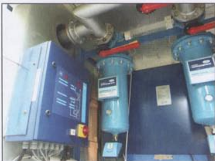
Fot. 2 Sekcja uzdatniania powietrza
