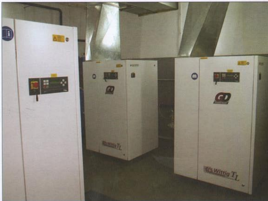
Fot. 1 Sprężarkownia w Prefabecie Puławy. Z lewej strony (fragment) niskociśnieniowa sprężarka Wittig ROL 120 – topline 75 kW, z prawej dwie maszyny Wittig ROL 65 topline (master i slave) o mocy 37 kW pracujące w kaskadzie energetycznej
