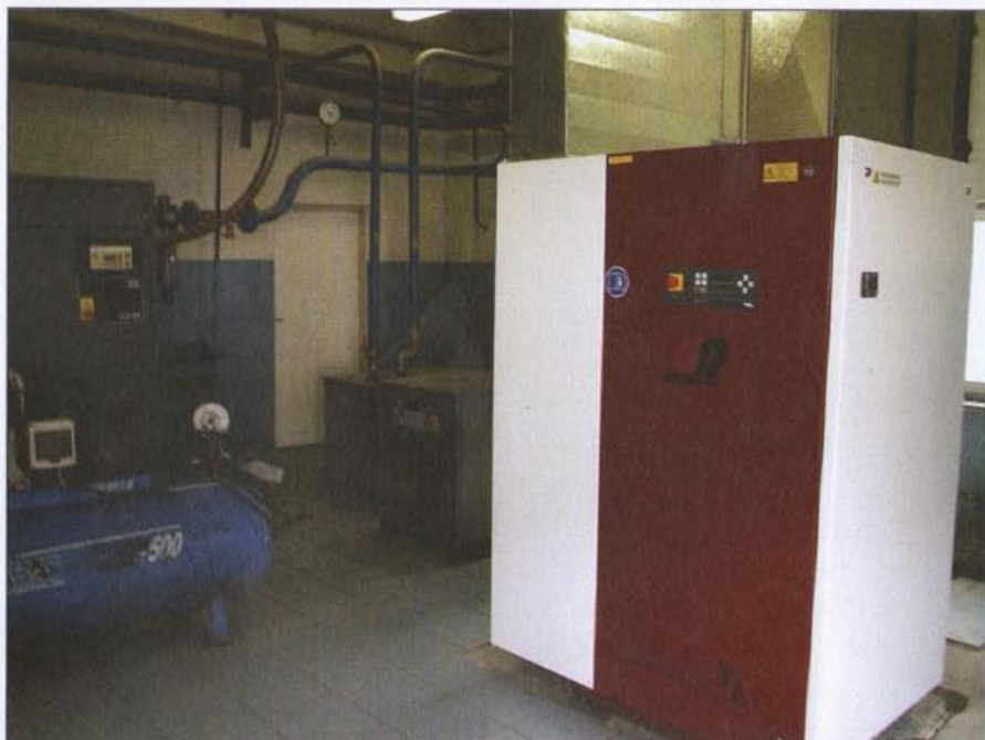
Fot. 2 Sprężarkownia w firmie Faelbet SA w Warszawie. Pionowa sprężarka Wittig ROW 85 topline (55 kW)
