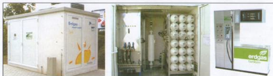
Fot. 2 Stacja do tankowania zbiorników gazu ziemnego z dystrybutorem
