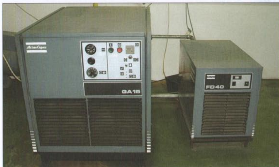
Fot. 12 Ciągłą dostawę sprężonego powietrza na potrzeby całego zakładu zapewniają nowoczesne sprężarki Atlas Copco (dwie GA-22 i jedna GA-15). Tu obok sprężarki GA-15 widoczny jest osuszacz ziębniczy.
