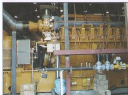
Fot. 3 Silniki gazowe Caterpillar
