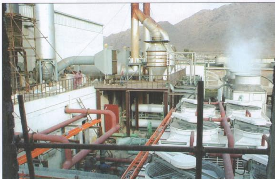
Fot. 2 Blok energetyczny zakładów tekstylnych w Gadoon w Pakistanie
