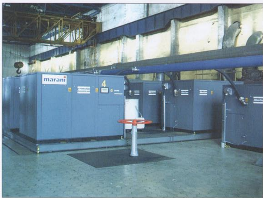
Fot. 3 Nowoczesna sprężarkownia zrealizowana przez firmę MARANI
