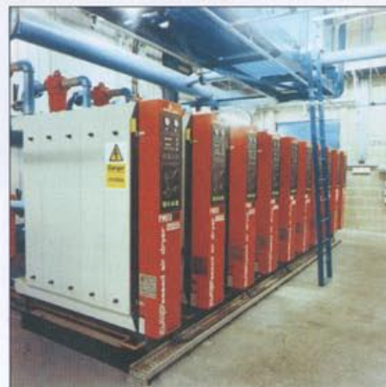
Fot. 2 Instalacje wielorzędowe
