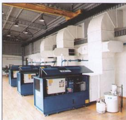
Fot. 1 Stacja sprężarek
