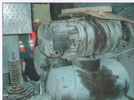
Fot. 5 Dmuchała Roots - Robox RBS przed remontem
