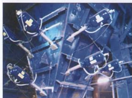
Fot. 2 Armatki powietrzne na zasobniku
