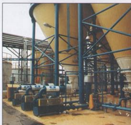
Fot. 2 Dmuchawy w zastosowaniu do transportu pneumatycznego materiałów sypkich w zakładach chemicznych
