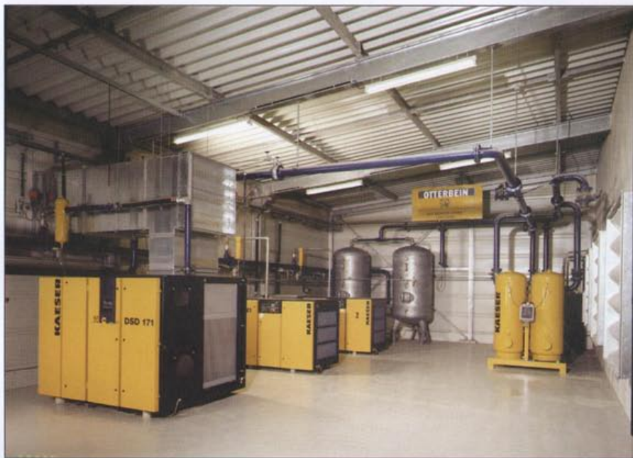
Fot. 1 Centralną sprężarkownię w Otterbein zaprojektowano z możliwością dalszej rozbudowy
