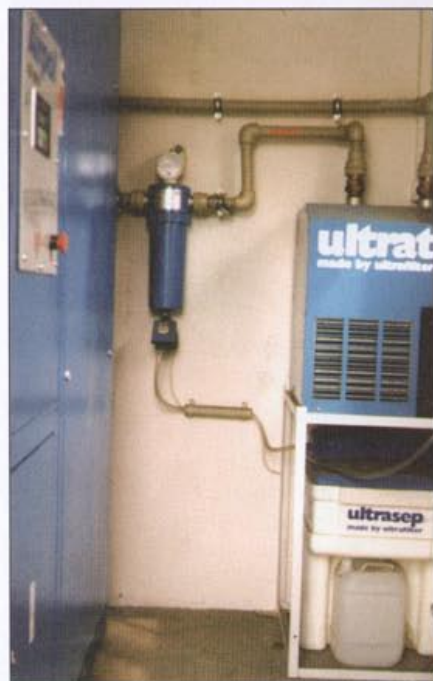
Fot. 1 Fragment instalacji sprężonego powietrza w Zakładzie Transportu KWB TURÓW
