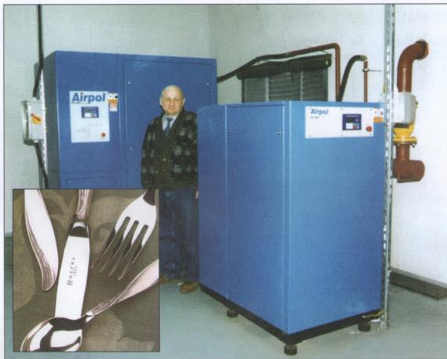
Fot. 2 Sprężarkownia w zakładzie FAM – POLSKA w Legnicy (oddział Warszawskiej Fabryki Platerów HEFRA SA). W lewym dolnym rogu przykładowe wyroby firmy
