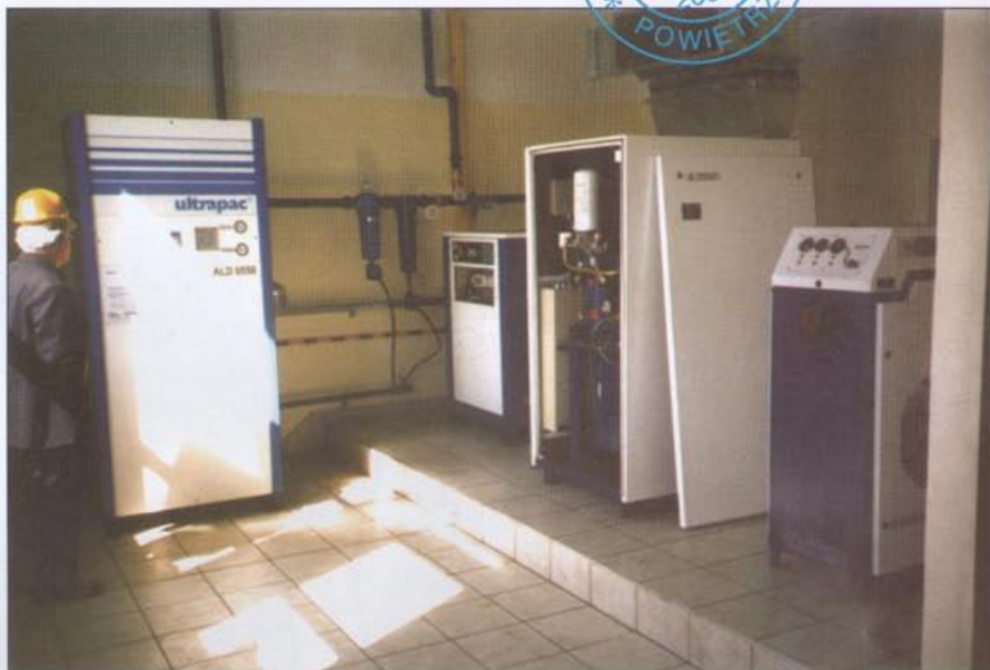
Fot. 1 Sprężarkownia terminalu BP Sławków. Od prawej: 15 kW sprężarka WIT-TIG ROL 20 baseline, z otwartą obudową - 30kW WITTIG ROL 50 topline, w głębi sprężarka śrubowa. Przy lewej ścianie osuszacz adsorpcyjny ultrafilter ALD
