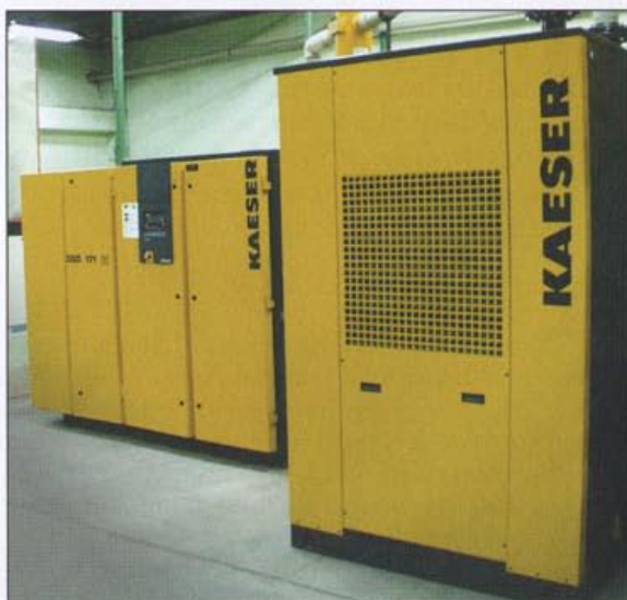
Fot. 2 Osuszacz TF171 i sprężarka śrubowa DSD171 firmy Kaeser Kompressoren z napędem bezpośrednim DSD 171
