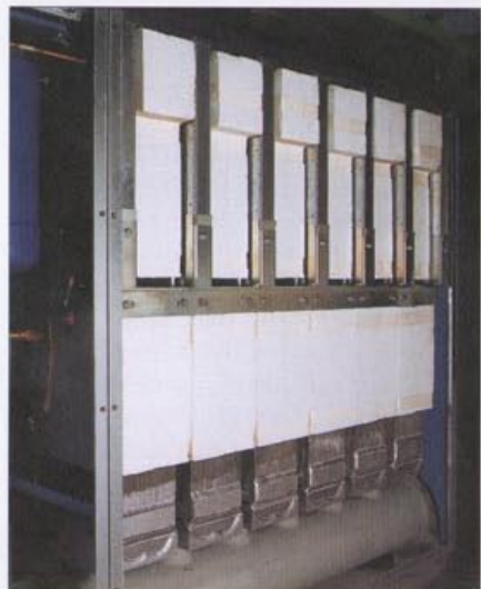
Fot. 2 Bateria wymienników ciepła
