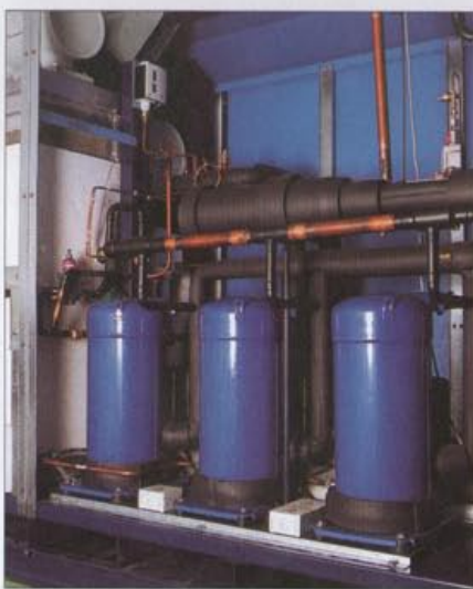
Fot. 3 Układ sprężarek umożliwiający regulację wydajności układu chłodniczego
