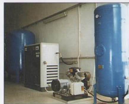
Fot. 5 Sprężarkownia (sprężarka śrubowa i doprężacz)
