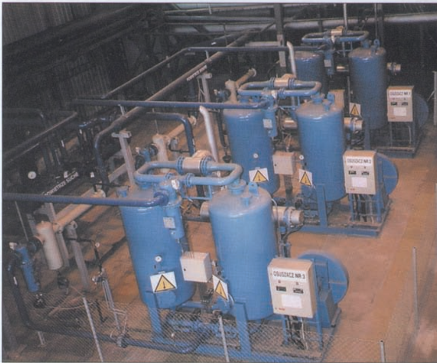
Fot. 3 Nowa stacja osuszania sprężonego powietrza firmy ultrafilter
