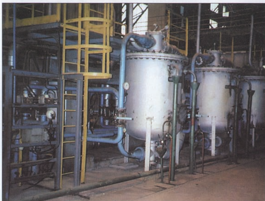
Fot. 1 Dotychczasowa stacja osuszania sprężonego powietrza
