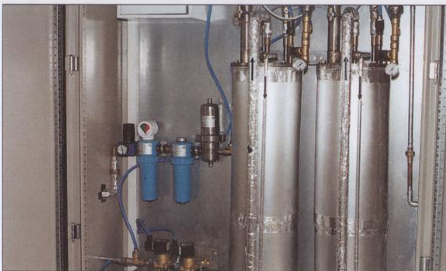
Fot. 3 Część systemu uzdatniania powietrza firmy ultrafilter
