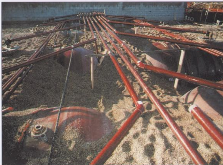
Fot. 2 Instalacja podziemna wykonana z kompozytów (z materiałó firmy Ameron)
