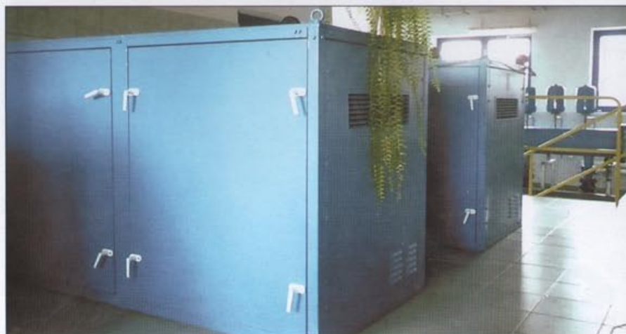
Fot. 1 Dmuchawy DR125T w osłonach dźwiękochłonnych na stacji uzdatniania wody w Lublinie
