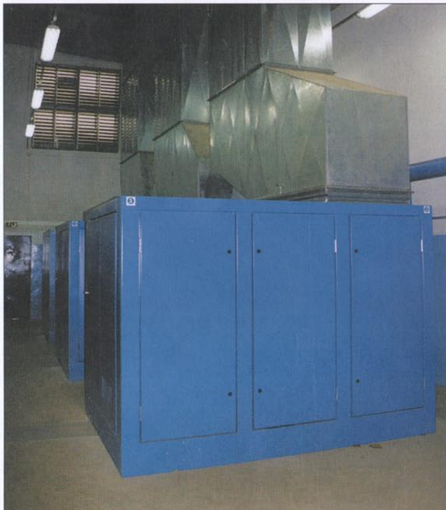
Fot. 2 Sprężarka SIRIUS 250 w Stoczni Gdańskiej
