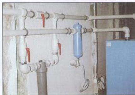
Fot. 2 Fragment instalacji z elementami uzdatniania sprężonego powietrza firmy RE-FIND
