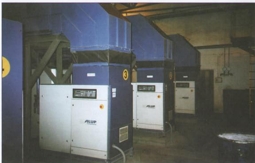
Fot. 1 grupa sprężarek ALUP serii SCK o mocach 37-315 kW zasilających instalację w cementowni
