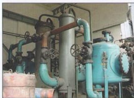
Fot. 1 Dotychczasowy układ uzdatniania sprężonego powietrza
