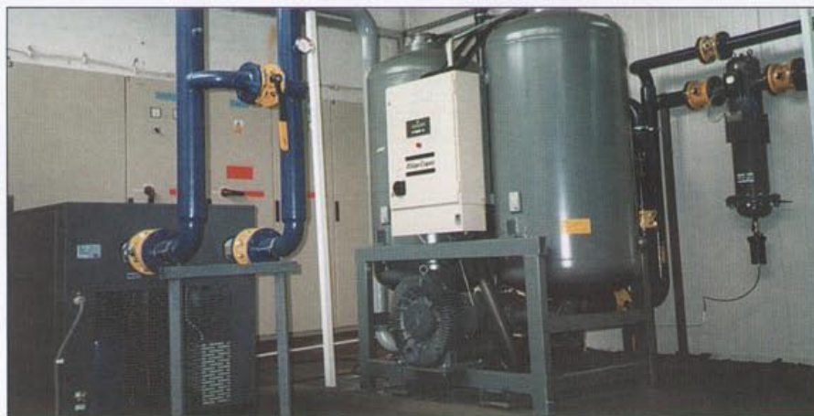
Fot. 2 Nowy system uzdatniania sprężonego powietrza
