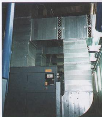
Fot. 3 Sprężarka GA90C wraz z układem kanałów wentylacyjnych
