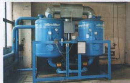
Fot. 3 Instalacja osuszania sprężonego powietrza w EC Tychy
