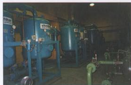
Fot. 1 Instalacja osuszania sprężonego powietrza w Elektrowni „Łaziska”
