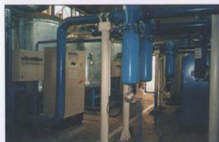
Fot. 2 Instalacja osuszania sprężonego powietrza w Elektrowni „Siersza”
