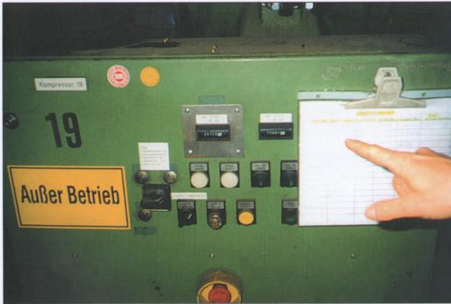
Fot. 2 Może to nie jest na fotografii widoczne, ale palec prezesa Andrzeja Wiczorka wskazuje zapis wykonania przeglądu eksploatacyjnego po 159 000 godzinach pracy sprężarki WITTIG ROW 370 (250 kW). Parametry, dla innych konstrukcji absolutnie nierealne, w przypadku łopatkowych sprężarek firmy Gardner Denver WITTIG GmbH są standardem
