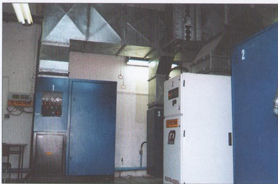
Fot. 1 Sprężarkownia w „Pudliszkach”, gdzie firma Vector skutecznie wykonała zadanie zintegrowania systemu. Na zdjęciu widać 4 sprężarki różnej wielkości sterowane poprzez sterownik MULTIPILOT (sprężarki 2×30 kW, 22 kW, 45 kW)
