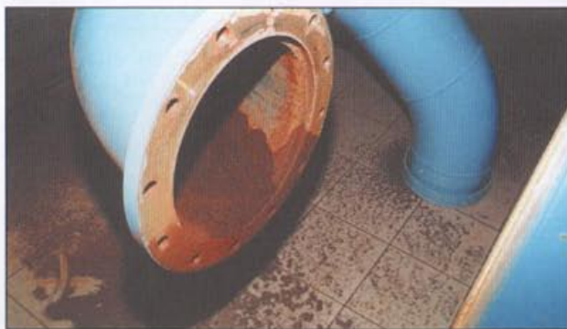
Fot. 1 Zwały rdzy w rurociągu sprężonego powietrza
