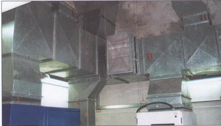
Fot. 1 Prawidłowo wykonane kanały wentylacyjne odprowadzające ciepłe powietrze
