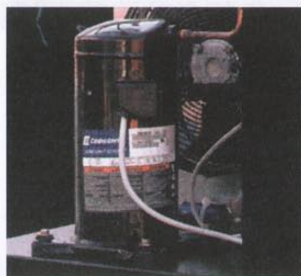
Fot. 4 Sprężarka spiralna
