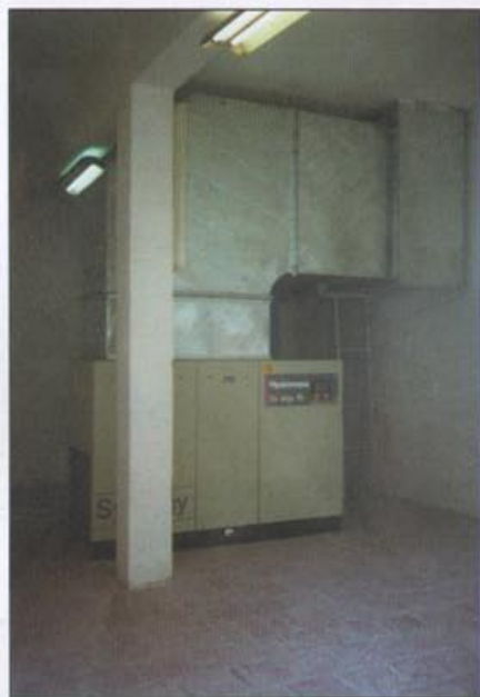
Fot. 1 Sprężarka Hydrovane Synergy 75 w Zakładzie Budowy Maszyn SA Huty Zabrze. Efekty oszczędnościowe zwiększa także przemysłowe wykorzystanie gorącego powietrza odpadowego. Prawdopodobnie więcej ze sprężarek nie da się już „wycisnąć”.
