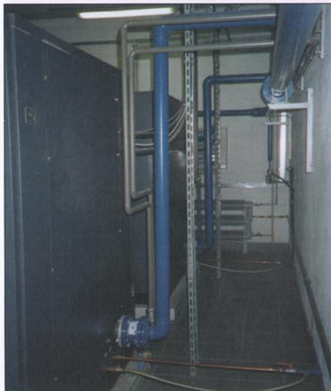
Fot. 3 Sprężarki Atlas Copco z zainstalowanymi modułami odzysku ciepła – wszystkie przyłącza z jednej strony
