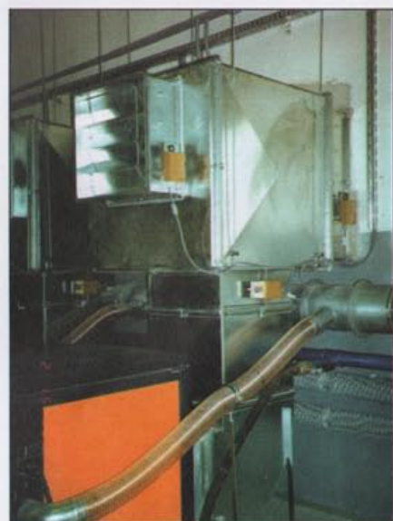
Fot. 1 Fragment układu wylotowego sprężarki chłodzonej powietrzem (wyraźnie widać przepustnicę recyrkulacyjną oraz napędy przepustnic regulacyjnych i zwrotnych)
