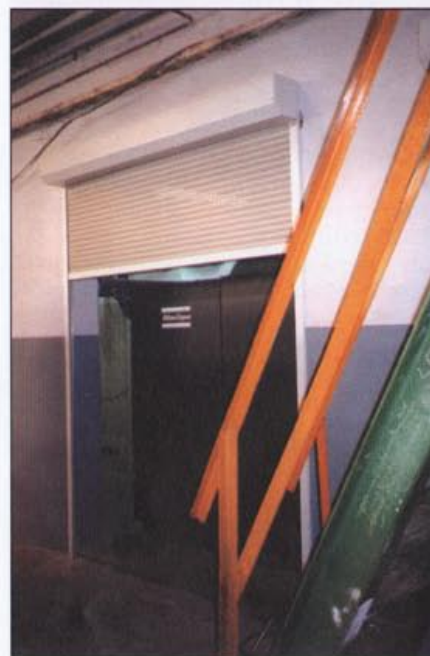
Fot. 2 Dodatkowy dostęp do sprężarki – zdjęcie od strony hali produkcyjnej
