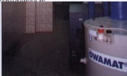
Fot. 1 Wąskie pomieszczenie nowej sprężarkowni. W głębi widoczne są sprężarki wraz z kanałem wentylacyjnym
