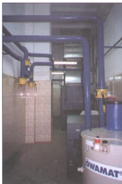
Fot. 1 Wąskie pomieszczenie nowej sprężarkowni. W głębi widoczne są sprężarki wraz z kanałem wentylacyjnym
