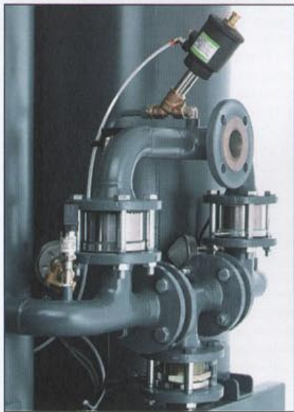
Fot. 3 Króćce przyłączeniowe
