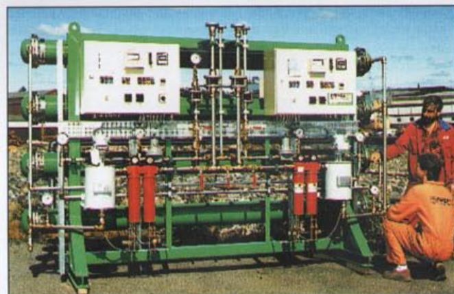
Fot. 2 Instalacja do separacji azotu
