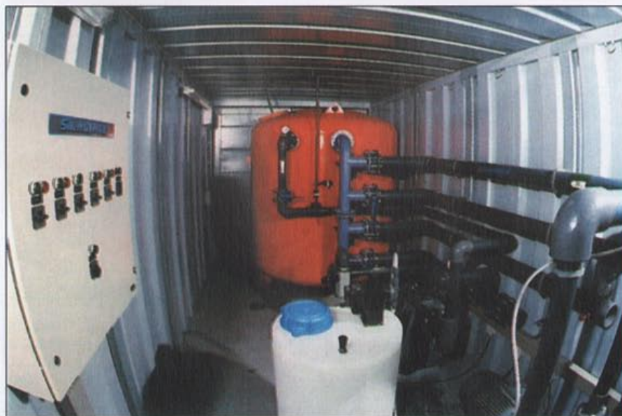
Rys. 1 Wygląd kontenerowej stacji z filtrem ciśnieniowym do uzdatniania wody
