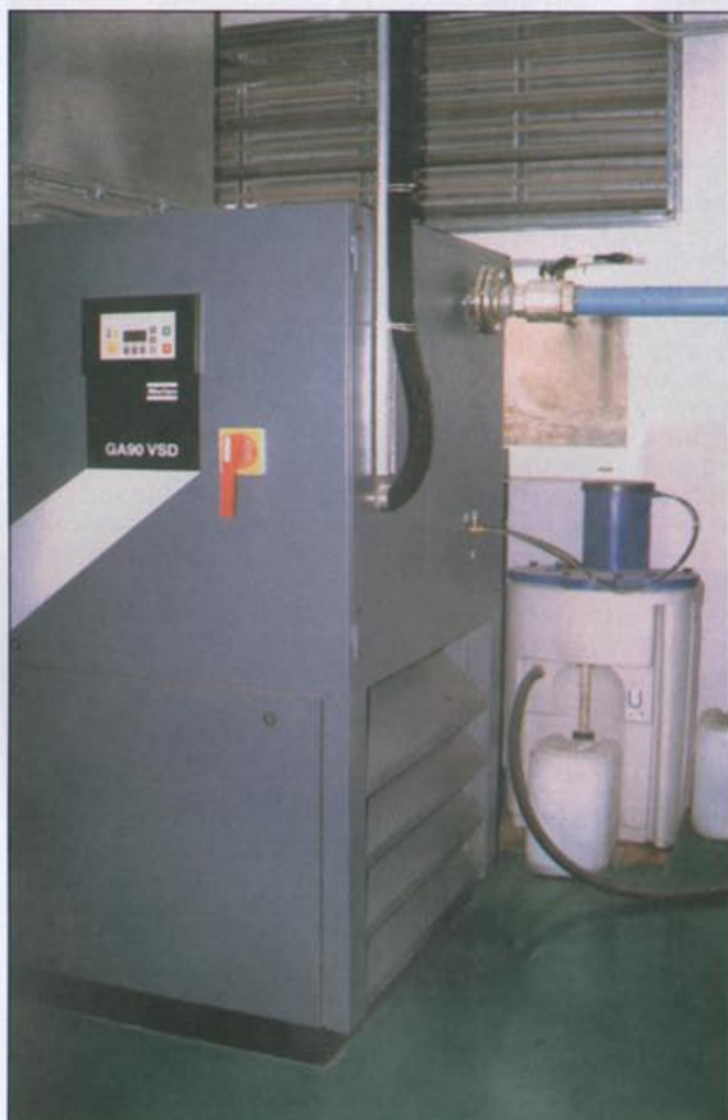
Fot. 1 Sprężarka GA90VSD przejęła funkcję sprężarki wiodącej i sterującej całością
