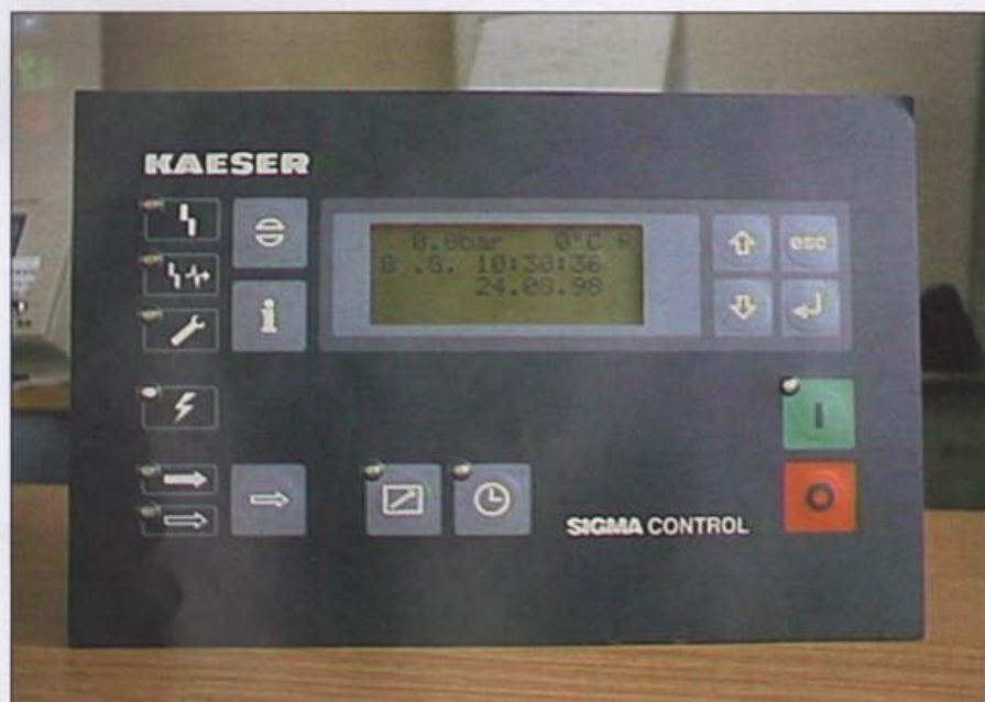
Fot. 2 Widok panelu obsługowego Sigma Control
