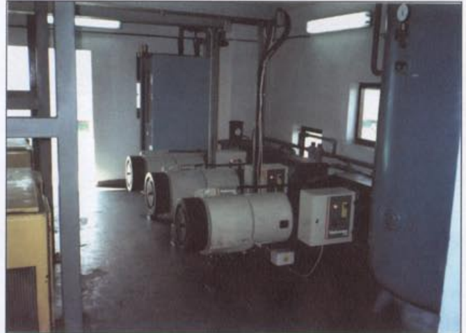
Fot. 1 Zespół sprężarek HYDROVANE 830 PUAS w Zakładach Krüger Polska Sp. z o.o. Po lewej stronie nie używane sprężarki śrubowe
