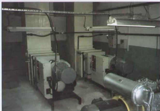
Fot. 2 Piotrkowska Fabryka Mebli. Dwie sprężarki HYDROVANE 955 PUAS dostarczają ok. 20 m 3 /min. Gorące powietrze w systemie recyrkulacji ogrzewa hale produkcyjne
