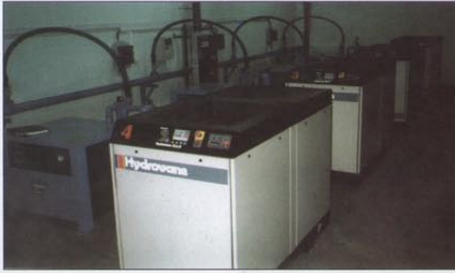
Fot. 4 Sprężarki Hydrovane 845 AIRLOGIC w Z.P.J. Miranda SA w Turku. Czerwona lampka na sprężarce nr 1 informuje o konieczności wymiany oleju. Instalacja powietrzna wykonana w systemie LEGRIS
